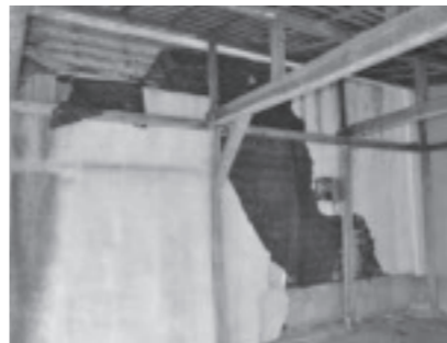
地震により脱落した壁
