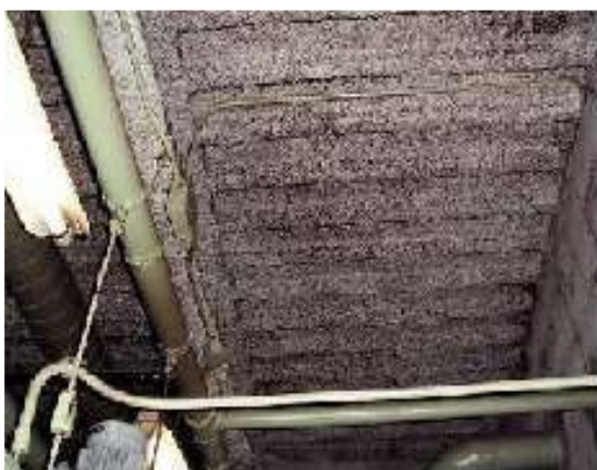
石綿含有吹付けロックウール
