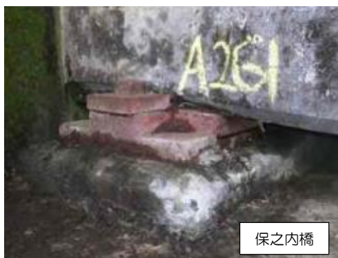
写真 3-3-43 防食機能の劣化
