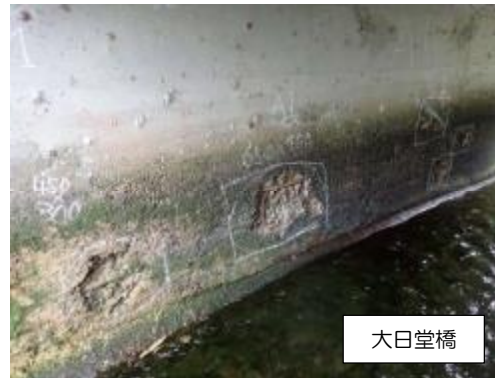
写真 3-3-38 剥離・鉄筋露出
