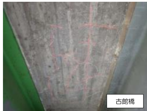
写真 3-3-16 床版ひびわれ
