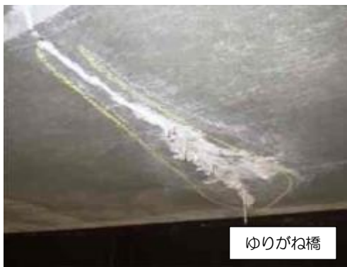
写真 3-3-15 漏水・遊離石灰
