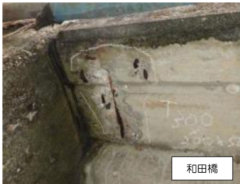
写真 3-3-21 剥離・鉄筋露出(1)
