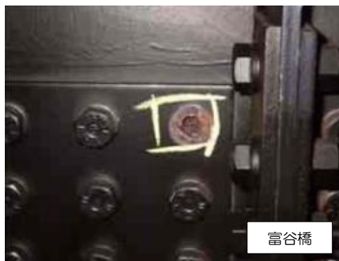
写真 3-3-3 ボルトの脱落
