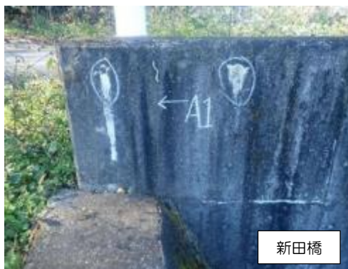
写真 3-3-39 漏水・遊離石灰
