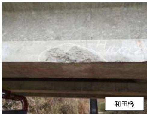
写真 3-3-11 剥離・鉄筋露出(1)
