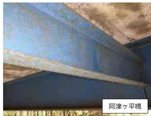
写真 3-3-28 防食機能の劣化(2)
