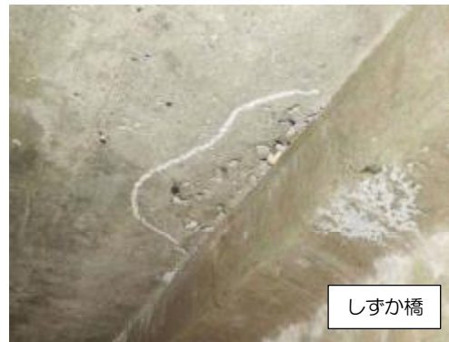
写真 3-3-22 剥離・鉄筋露出(2)
