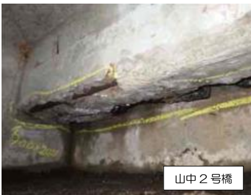
写真 3-3-31 剥離・鉄筋露出(2)
