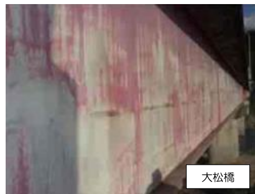
写真 3-3-4 防食機能の劣化
