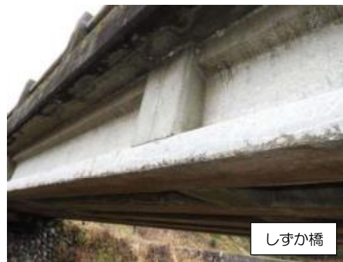
写真 3-3-12 剥離・鉄筋露出(2)
