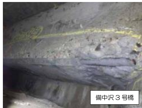
写真 3-3-30 剥離・鉄筋露出(1)
