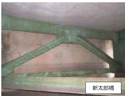
写真 3-3-27 防食機能の劣化(1)
