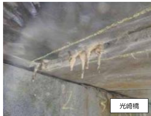
写真 3-3-24 漏水・遊離石灰(2)
