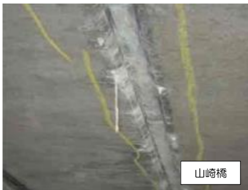
写真 3-3-23 漏水・遊離石灰(1)
